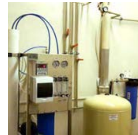
Seit August 2017 ist die neue Wasseraufbereitungsanlage in Betrieb.
