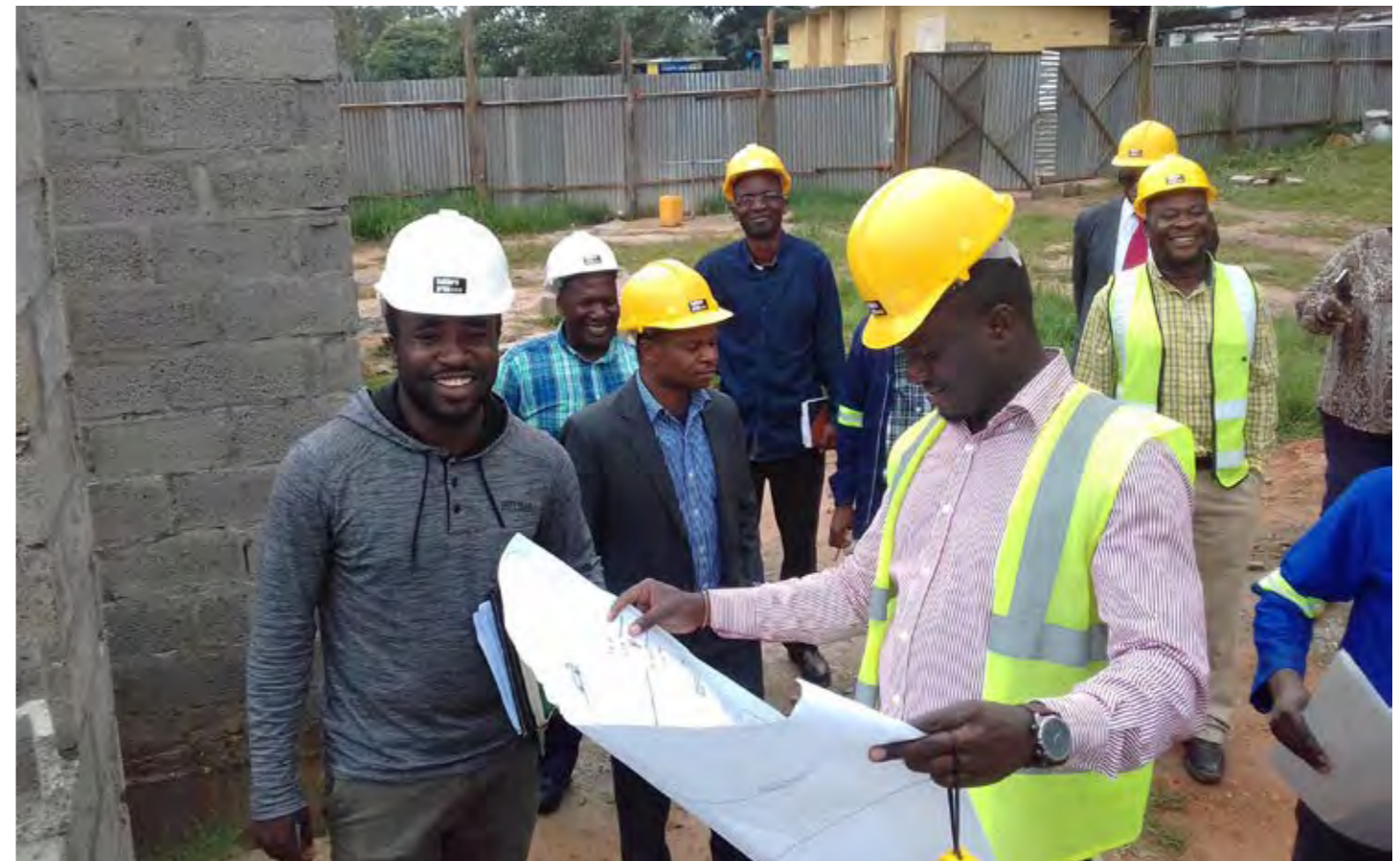
Im vollen Gange: Bauarbeiten für die Augenklinik auf dem Gelände des Regierungskrankenhauses in Chipata.
